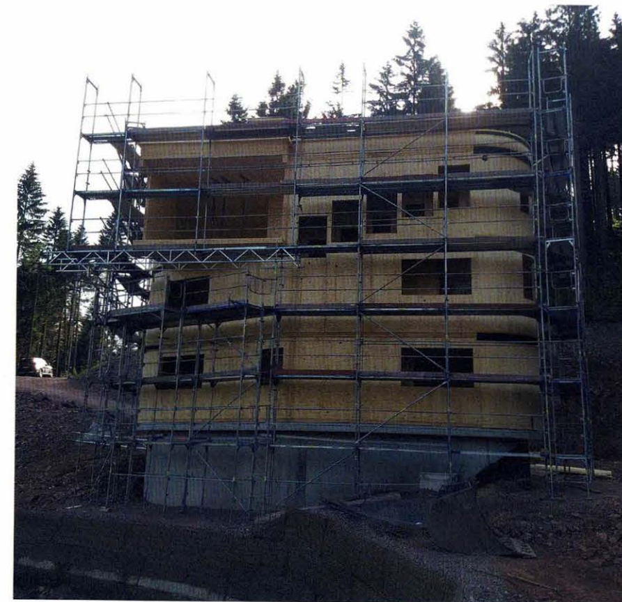
Bild 12: Der Holz-Rohbau steht. Die Fenster können eingebaut und die Fassadenbekleidung samt Wärmedämmung aufgebracht werden. (Bildquelle: SGHG Planungs- und Prüfgesellschaft Bautechnik mbH)
